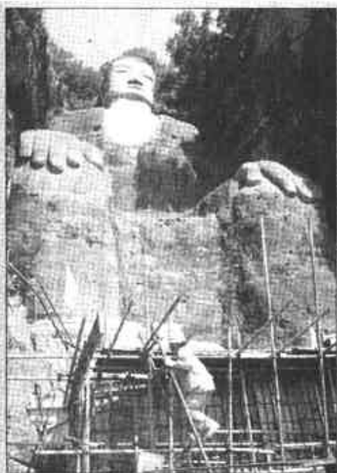
距今已有1200年历史的四川乐山大佛,继去年大佛面清污维修之后,经过半年多的精心准备,乐山大佛佛脚平台拓展工程5月中旬正式开工。目前,整个工程的水下部分已全部完工,水上部分正在进行之中,乐山大佛正接受第二次大规模“康复治疗”。 新华社记者 孙忍 摄
